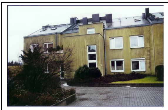
Abb. 2. Algenbefall durch planerische Mängel in Verbindung mit dem Mikroklima an der Fassade
