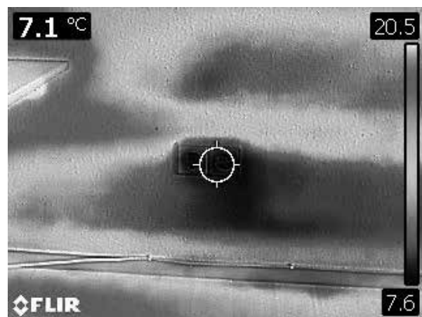
Abb.1. Fehlerhaft installierte Steckdose
