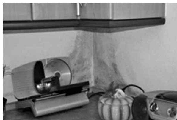
Abb. 3. Einbaumöbel vor der Innendämmung mit Schimmelbefall
