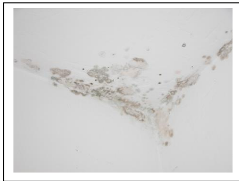
Abbildung: Kondensationsschaden durch Wärmebrücke Quelle: Robert Kussauer
