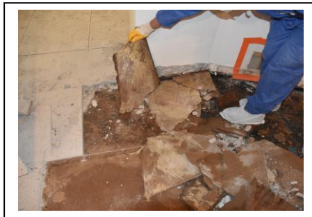
Abb. 1 Großer mikrobieller Schaden Quelle: Robert Kussauer
