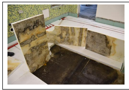
Abbildung: Estrichdämmschicht, mikrobieller Befall durch länger einwirkende Feuchtigkeit. Eine Trocknung der Fußbodenkonstruktion ist nicht sinnvoll. Es ist ein Rückbau erforderlich Quelle: Robert Kussauer
